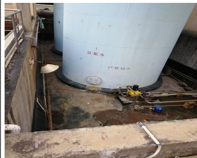
双氧水储罐区围堰
