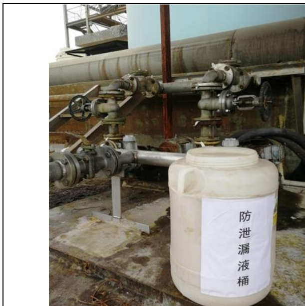
配药间防泄漏桶
