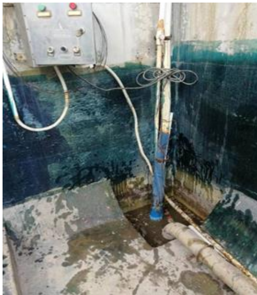
储药罐区收集井
