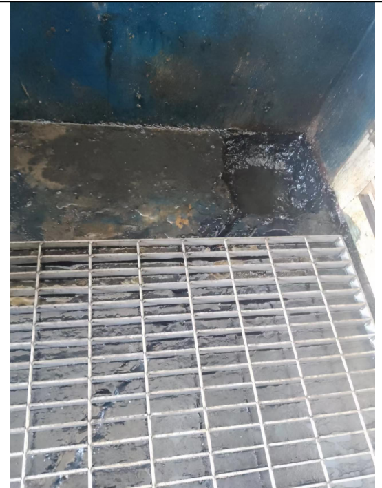
1#危废仓防泄漏槽
