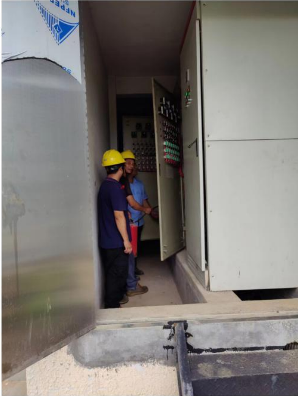
高级电工讲解可能引起电房起火的原因，如何使用电房配备的二氧化碳灭火器进行扑灭火源
