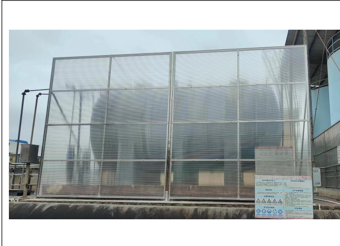
硫酸加药罐围堰
